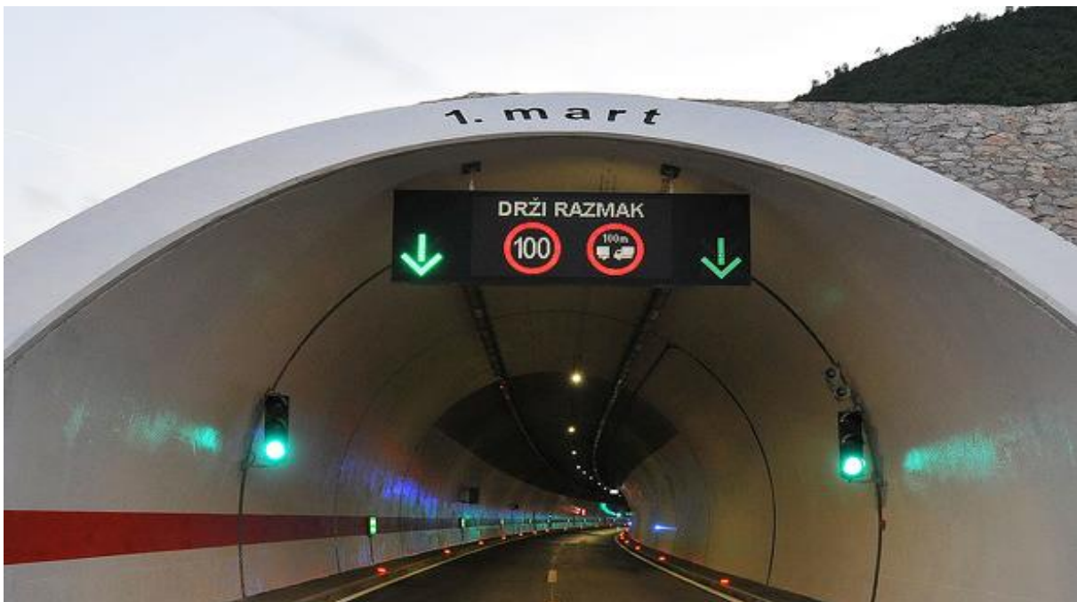
Sl. 2 – Primjer displeja na stropu tunela
