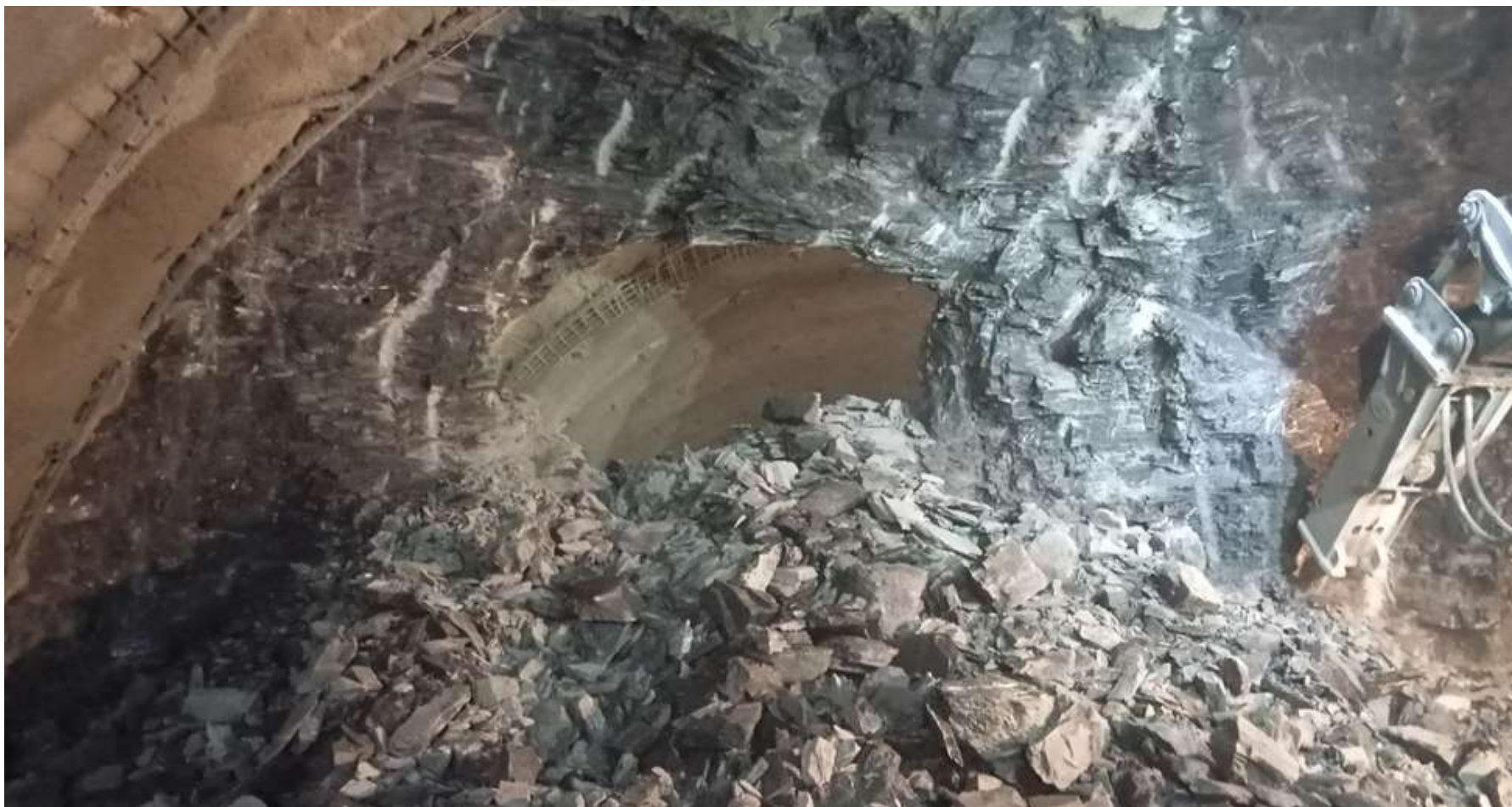
Slika br. 2: Tunel Hranjen - radovi na proboju kalote glavne tunelske cijevi - jug na km 6+026,00
