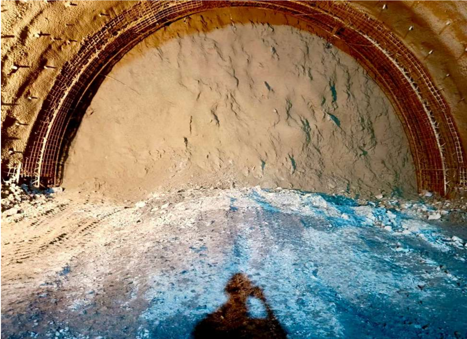
Slika br. 1: Tunel Hranjen - radovi na iskupu i podgrađivanju kalote glavne tunelske cijevi - jug
