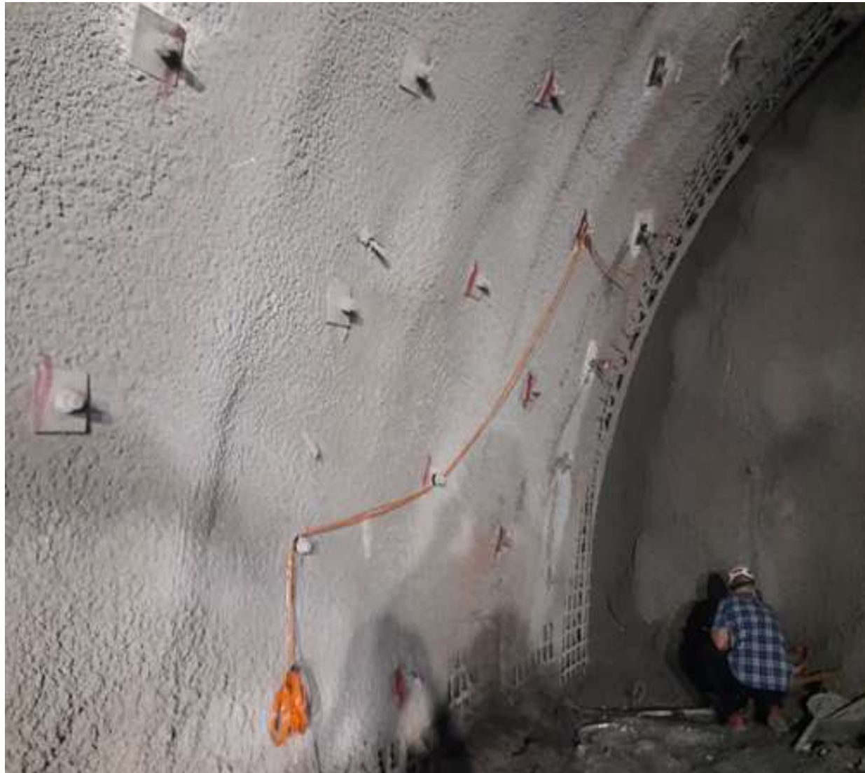
Slika br. 2: Tunel Hranjen - radovi na ugradnji ekstenziometara glavne tunelske cijevi - sjever i jug
