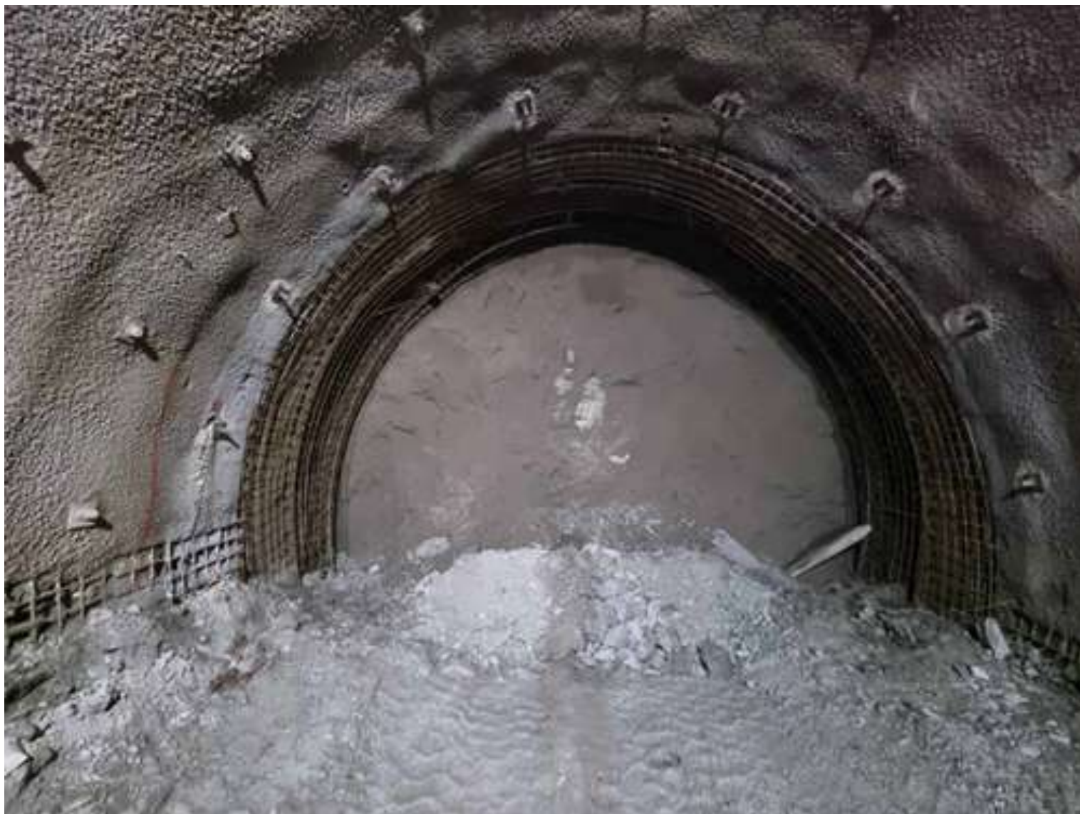
Slika br. 4: Tunel Hranjen - radovi na iskopu i prilagođavanju kalotne servisne tunelske cijevi - sjever
