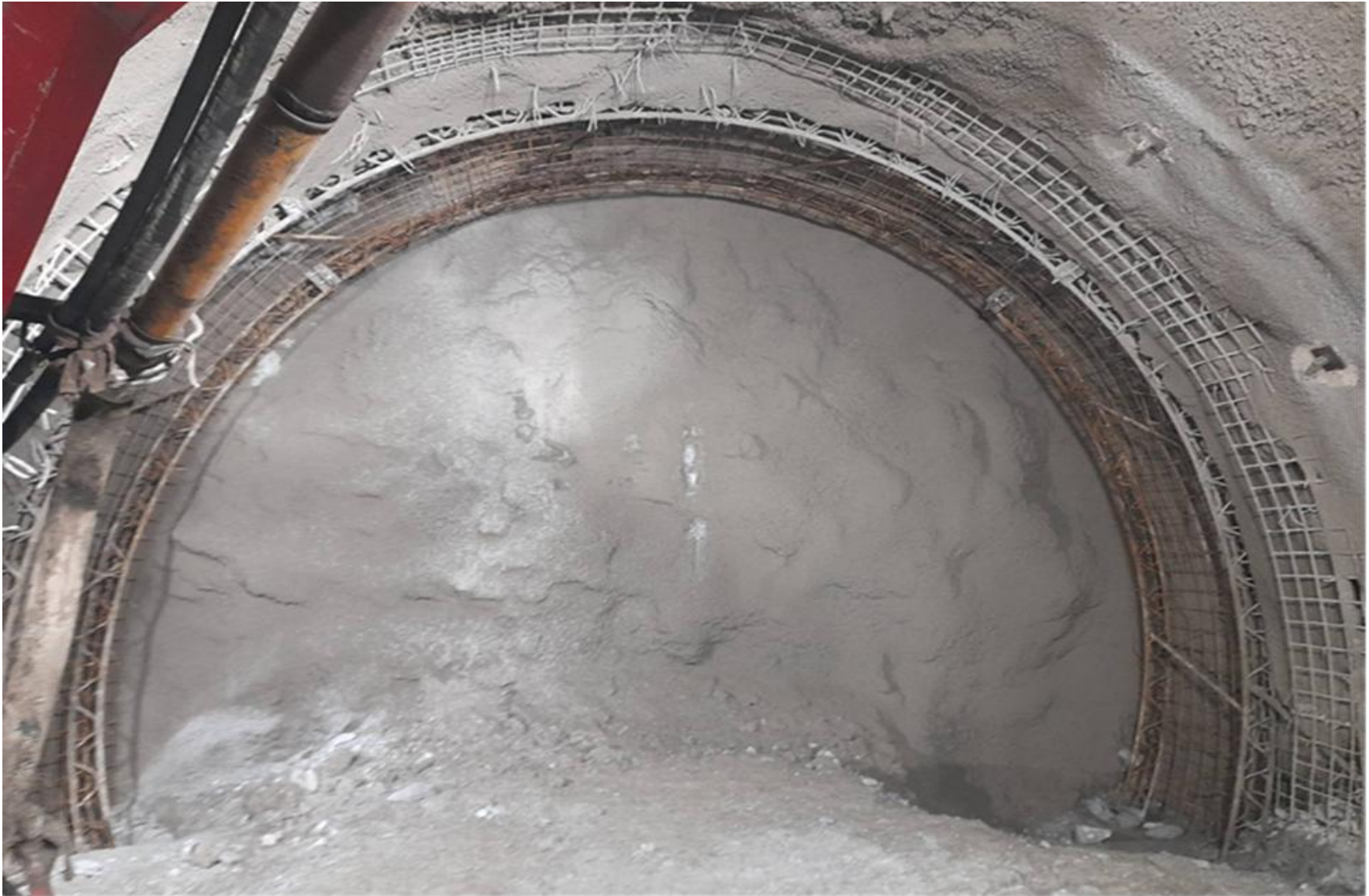
Slika br. 3 – Radovi na iskopu i podgrađivanju kalote i stepenice servisne tunelske cijevi - sjever
