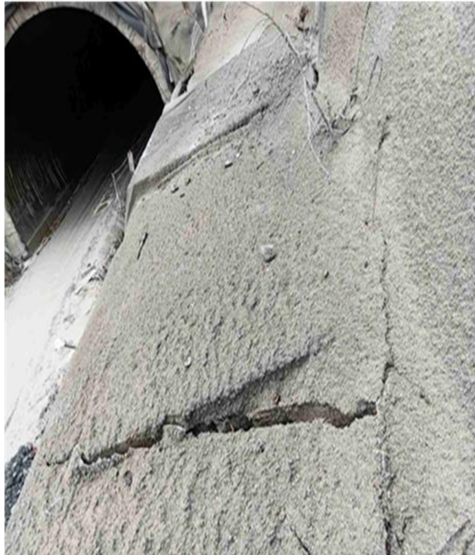
Slika br. 2 – Oštećenje lijeve kosine južnog predusjeka (Tunel Hranjen)
